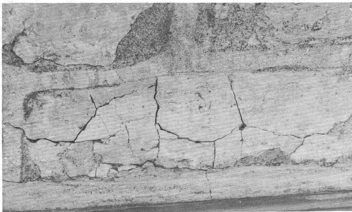
On voit ici des fissures dans la maçonnerie.
